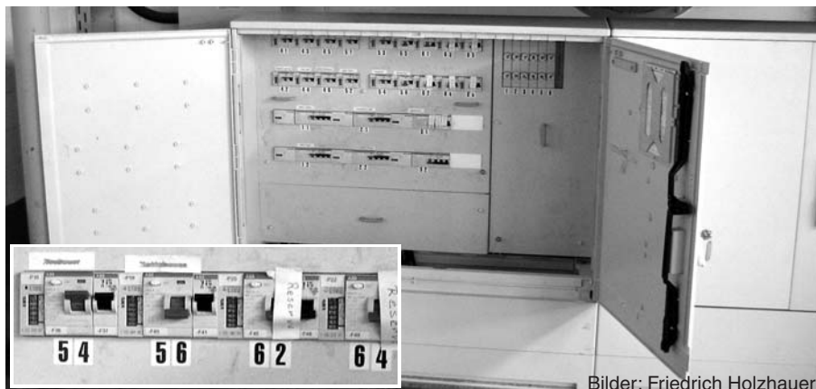
Bilder: Friedrich Holzauer Im neuen Stromverteilerkasten, in der Tiefgarage unter dem Bonner Wochenmarkt, hat jeder Markthändler seinen eigenen Anschluss mit Sicherung und Zähler.
